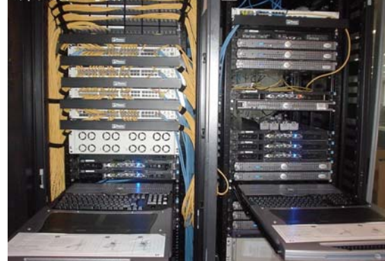
津田沼 7号館 2F サーバールーム
