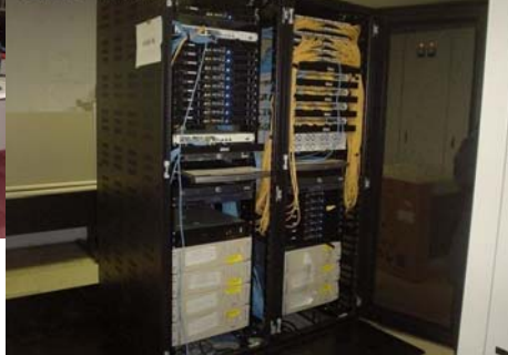
芝園 3号館 2F サーバールーム
