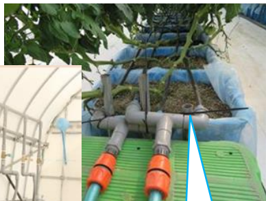
センサーと水・肥料用の配管
